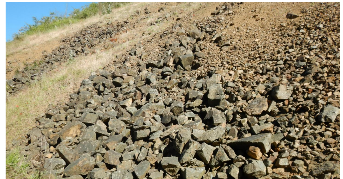
Photo 19 : zone ponctuelle d'éboulement sur une pente au sud de la butte
